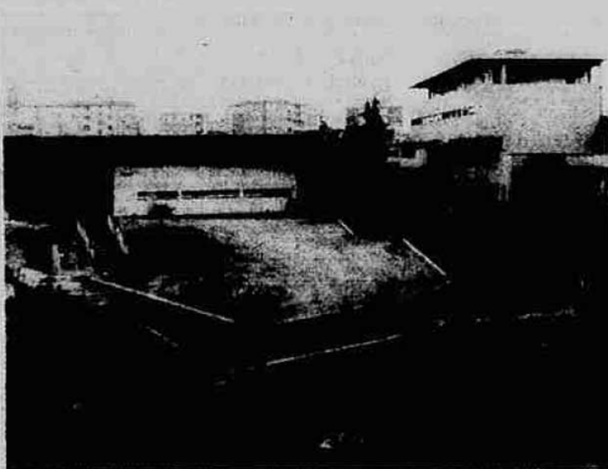
L'ingresso provvisorio, da via Don Minzoni, per la nuova stazione Mongrifi. Quello definitivo, formato "kolossal", è l'edificio sulla sinistra...
